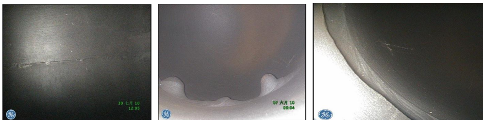
图2 未焊透、焊瘤缺陷、内部凹陷焊接缺陷
